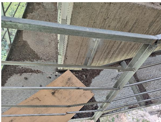
1. 检修通道护栏横杆断裂
