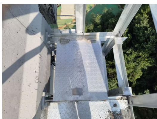
6. 爬梯盖板不能完全打开、放平
